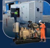
صيانة جميع أنواع المولدات GENERATORS MAINTENANCE
