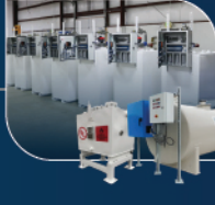
مضخات الوقود و الزيت FUEL / OIL PUMPS
