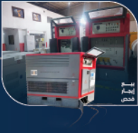
فحص وتشغيل اختبار المولدات على اللود LOAD BANK TESTING SERVICES
